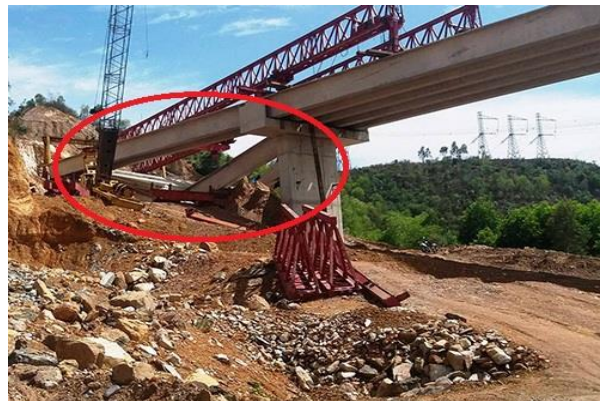
Hình 3. Sự cố gãy dầm do thi công cầu vượt đoạn La Sơn-Túy Loan trên cao tốc Huế- Đà Nẵng
