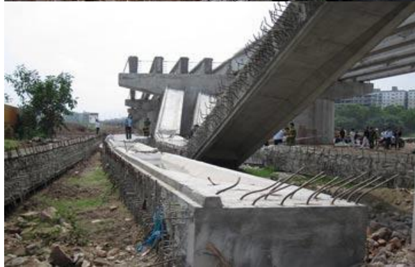
Hình 2. Sự cố gãy dầm đường vành đai 3.
